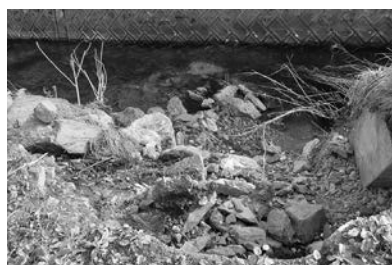
道仏川の崩落現場
