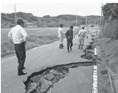
台風10号による被害現場
