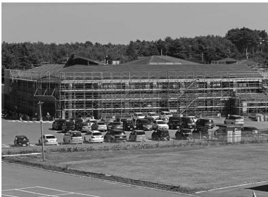
屋根の改修工事のあとに太陽光パネルが設置されるハートフルプラザ
