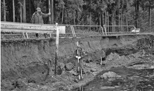
川が増水し、路肩が崩壊 (芦間沢川)
