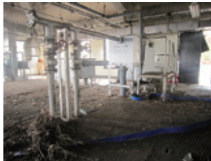
機能不全となった漁業集落排水処理施設。窓を突き破り、天井近くまで冠水した（3月15日撮影）
