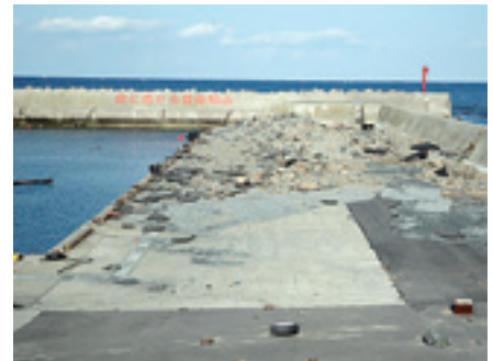
アスファルトがはがれ散乱した追越漁港（3月12日撮影）
