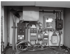
分電盤内 コンデンサー
