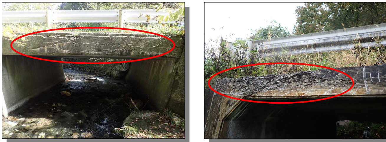
図3-5 凍害による損傷事例
