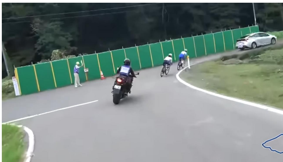
急カーブの個所にクッション材等のセーフティフェンスを設置(小松倉T字路)
